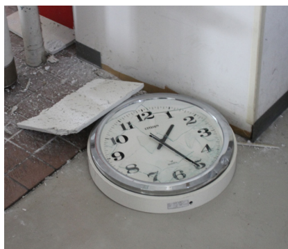
本震で床に落ち、割れた時計 (本震時間で止まっている)
