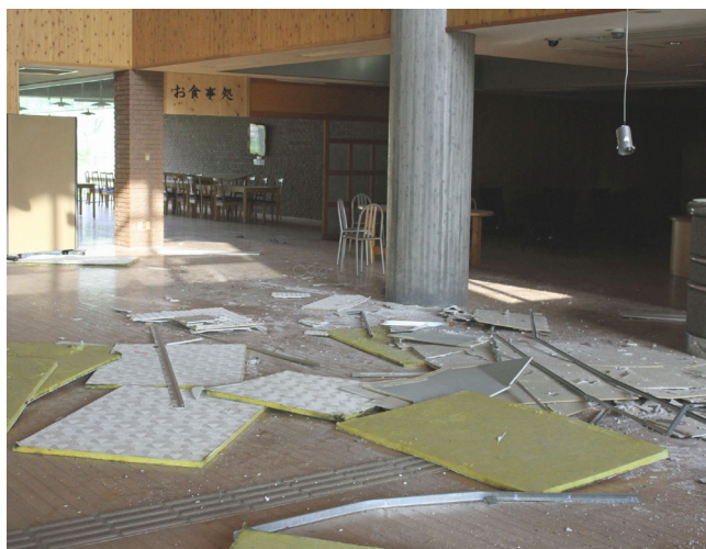
天井が床に落下した岩戸の里
