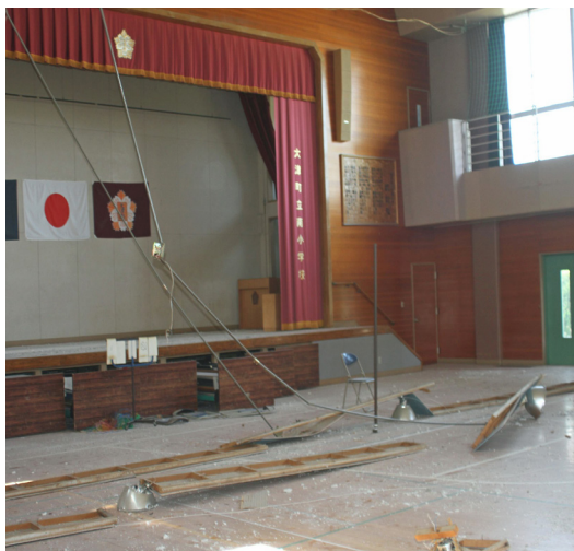
天井が落下した大津南小学校の体育館
