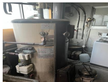
写真 4 薪風呂のボイラー
